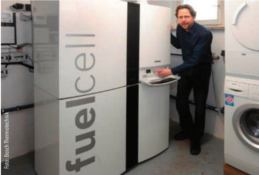
Bosch-Entwickler Wolfgang Friede hat die Brennstoffzelle in seinem eigenen Heizungskeller installiert.
